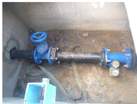
Figure 6-11 : Borne d'irrigation du périmètre irrigué El Khdirat
